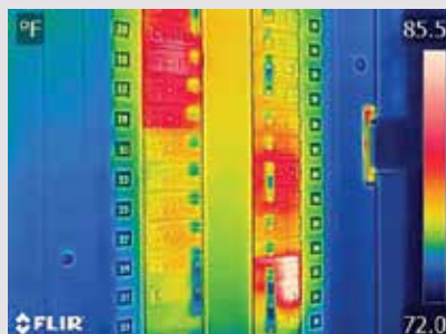
Щит с выключателями
